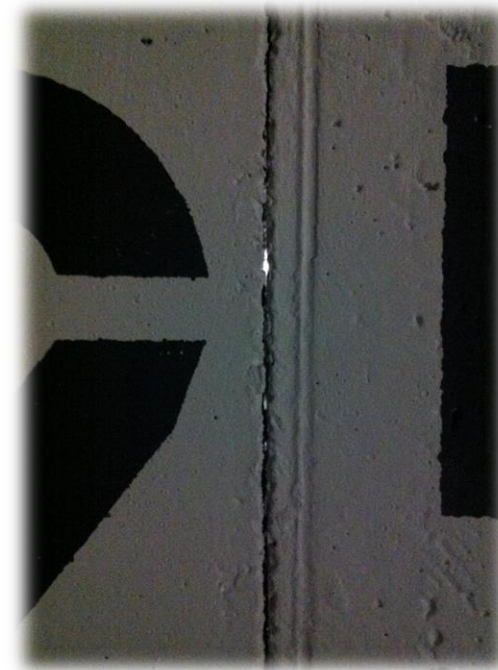
Bild 6, Riss in 80 m Wand ohne Sollbruchfuge
