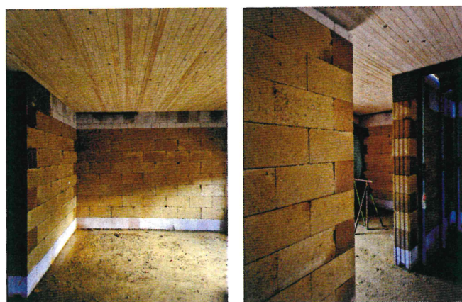
Bild 5 Tragende Lehmsteinwände mit Havarieschutz in der unteren Steinlage in Form eines Kalksandvollsteins, kombiniert mit einer Brettstapeldecke im Wohnungsbau
